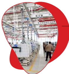
Hala testów zabezpieczeń
